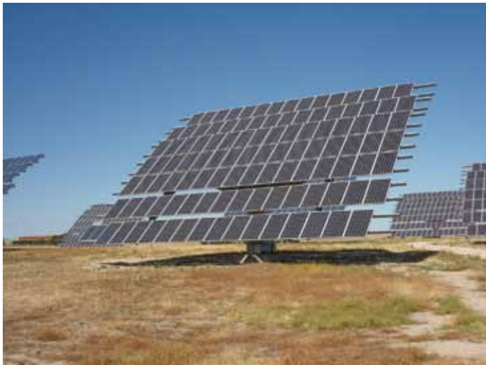
Figura 3.3. - PVPP in Herrerueta de Oropesa (provincia di Toledo, Spagna). La foto presenta un inseguitore a due assi di una vicina piantagione fotovoltaica PVPP.
