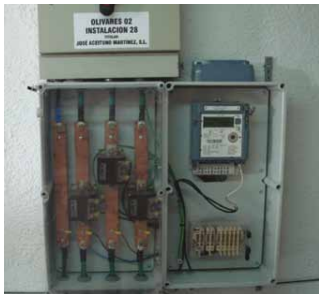
Figura 1.8 - Contatore di energia trifase, con un sistema di monitoraggio e di comunicazione.
