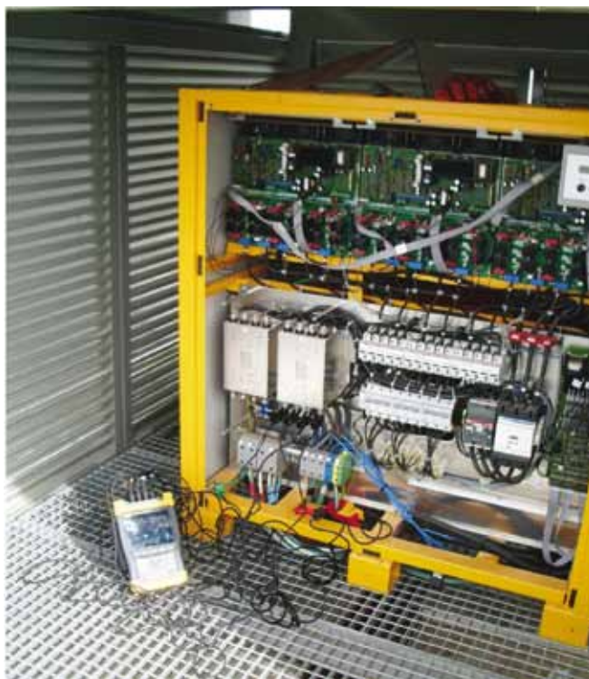
Figura 1.7 - Immagine di un inverter da 100-kW durante la realizzazione di verifiche di qualità.
